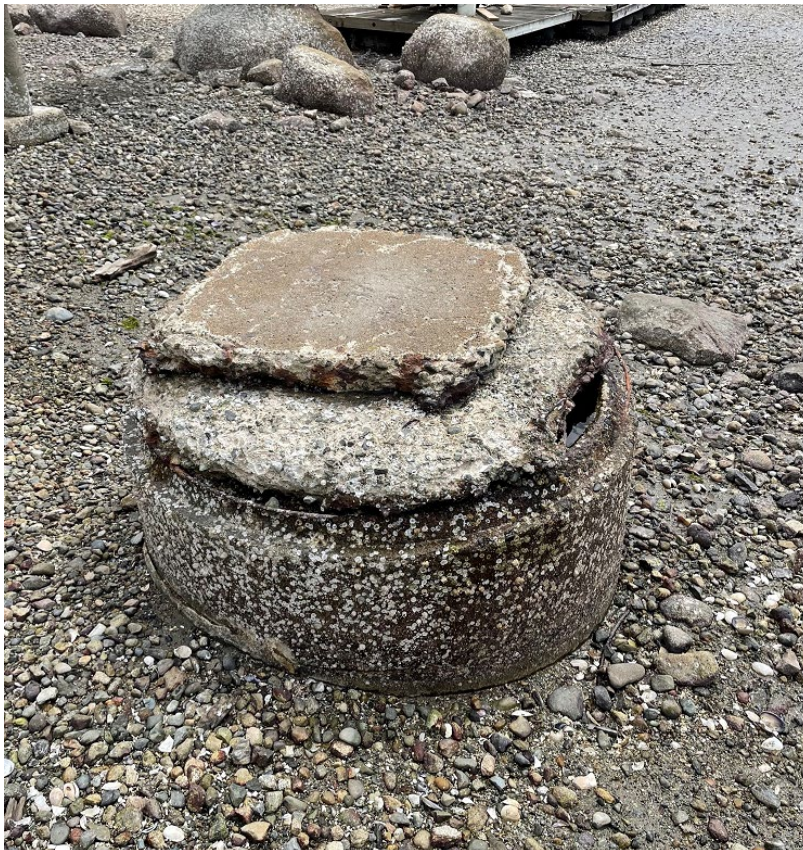
Exemple de point de jonction de conduite sanitaire le long de l'estran
