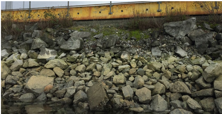
Figure 3 : Dommages mineurs à la crête supérieure d'une pente d'armure de roche.
